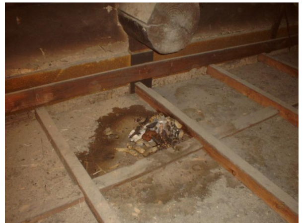
糞や尿で汚されてしまった天井裏
